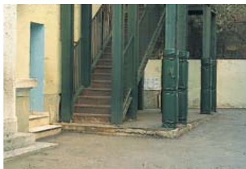
“Μισή δουλειά” σε σκάλα αυλής σχολείου. Μόνο μερικές κολώνες έχουν επένδυση ελαστικού. Η σκάλα την χρειάζεται περισσότερο (Δημοτικό σχολείο, Αθήνα 2005).
