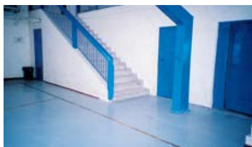
Ακατάλληλη χωροταξία κλειστού γυμναστηρίου: σκάλα-κάγκελα πολύ κοντά στα όρια του γηπέδου (μικρό περιθώριο διαφυγής παικτών) και έλλειψη κατάλληλου μαλακού υλικού γύρω από την στήριξη της μπασκέτας (Θεσσαλονίκη 2005).
