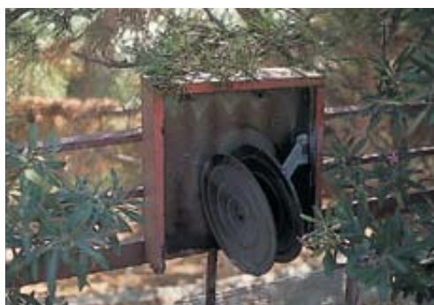
Πυροσβεστικό σημείο μόνο κατά όνομα (δυστυχώς σύνθητες στην Ελλάδα η περιφρόνηση της ουσίας).
