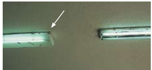
Κακή κατασκευή φωτιστικών σωμάτων (ετοιμόρροπο κάλυμμα, σκουριά). Θα πρέπει να δίνεται (από την επιβλέπουσα την κατασκευή των σχολείων υπηρεσία του ΟΣΚ) σημασία και στο εργοστάσιο παραγωγής (Ανατολική Χαλκιδική 1997).
