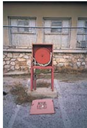
Η κατάσταση υποδεικνύει έλλειψη συντήρησης και ενδιαφέροντος.
