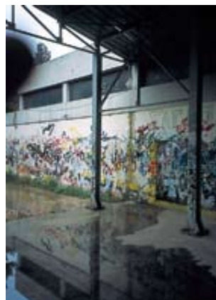
Σκεπαστός χώρος διαλείμματος και γυμναστικής με λιμνάζοντα νερά (Σχολείο Παπάγου-Αθήνα, 2003).
