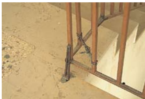
Πολύ αδύνατη κατασκευή και πολύ πρόχειρη επισκευή!
