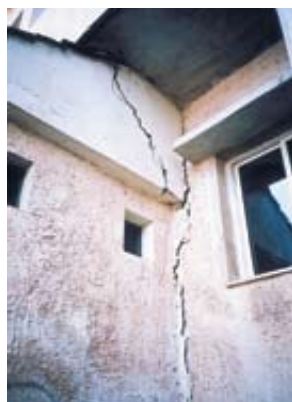
Μετασεισμική (;) επικίνδυνη ρωγμή στο σχολικό κτίριο (Θεσσαλονίκη 2005).
