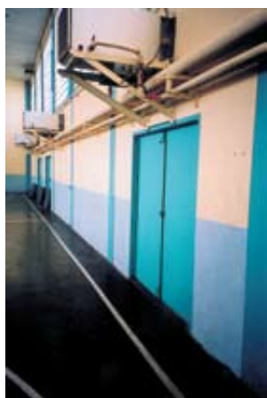
Επικίνδυνη τοποθέτηση κλιματιστικών μηχανημάτων σε κλειστό γυμναστήριο (Θεσσαλονίκη 2005).
