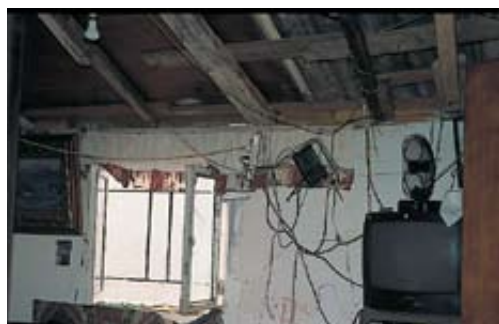
Κατοικία τσιγγάνων. Εμφανής ο κίνδυνος από τα ηλεκτρικά καλώδια. Ταξική προέλευση ατυχημάτων (N. Λιόσια Αττικής 2004).
