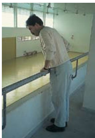
Χαμηλό κιγκλίδωμα στον εξώστη κλειστού γυμναστηρίου σχολείου.
